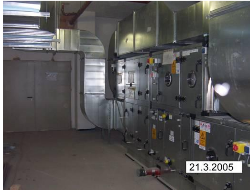
Lüftungsgerät Pflege 2 (5000m 3 /h)
