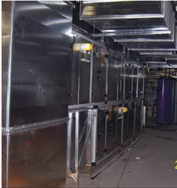
Lüftungsgerät Ambulanz (8000 m 3 /h)
